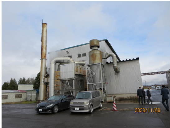
バイオマスボイラー
